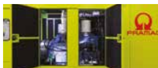
Большие двери для удобства осмотра и обслуживания
